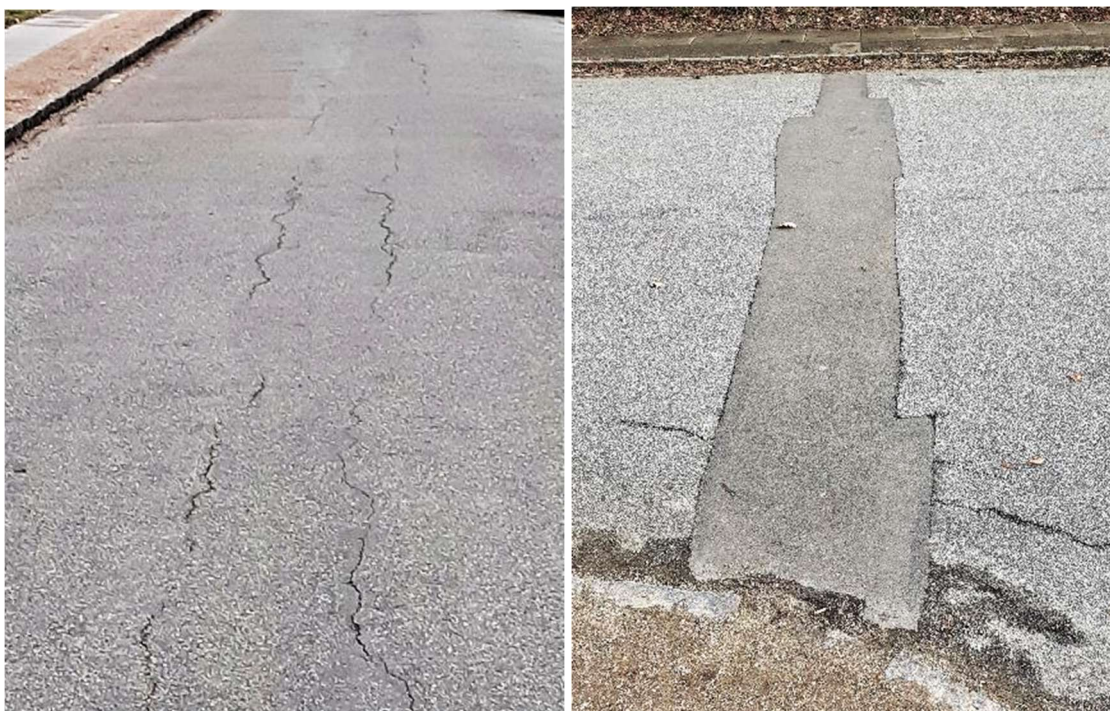
Foto 3.2.1.2.: Eksempler på større revner langsgående og tværgående, ved med ledningsarbejder.
