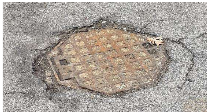
Foto 3.5.2.: Eksempler på skæve brønddæksler på ældre faste brønde.
