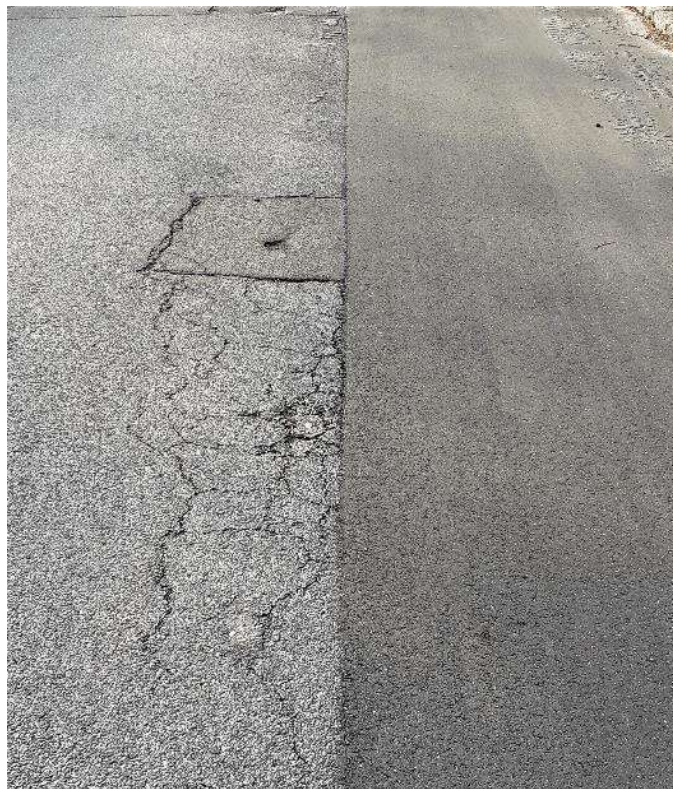
Foto 3.5.3.: Eksempler på sætningskader i forbindelse med nyere ledningsarbejder.
