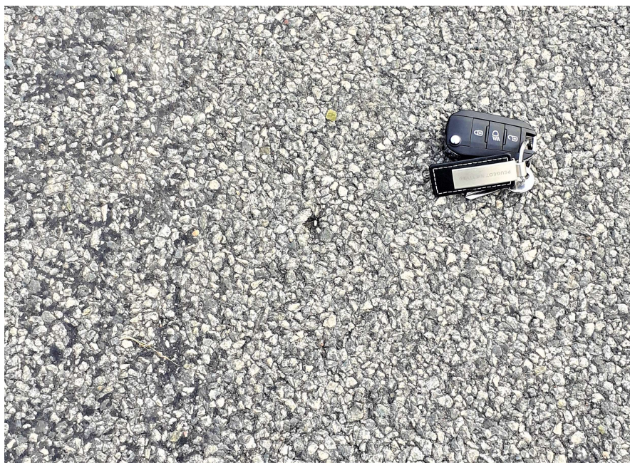
Foto 2.1.1.: Eksisterende slidlag – overfladebehandling (OB) med 5/8 mm skærver.
