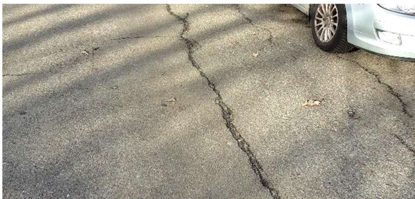
Foto 3.2.1.1: Eksempel på større revner, langsgående.
