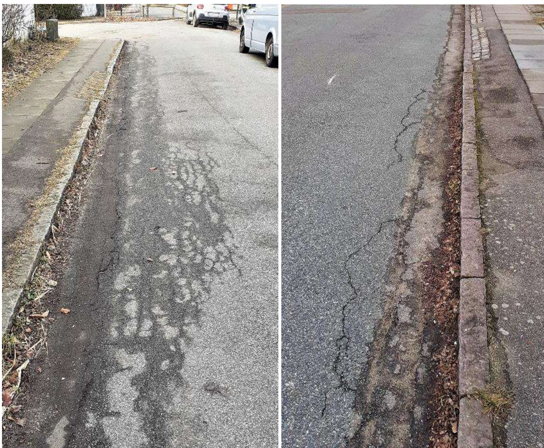
Foto3.4.2.: Eksempler på rendestens-trug med krakeleringer og sætningsrevner.
