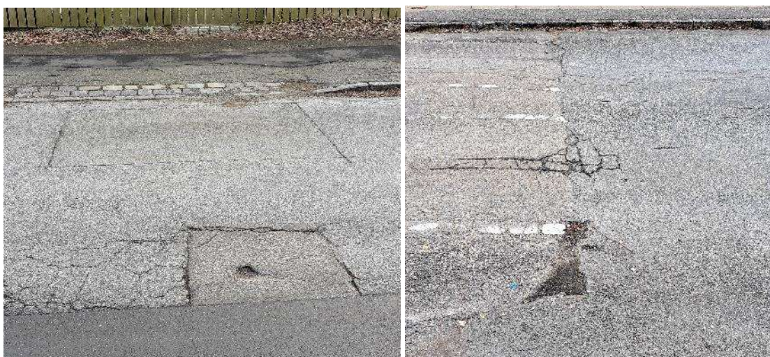
3.4.1.: Eksempler på lunker og sætninger.
